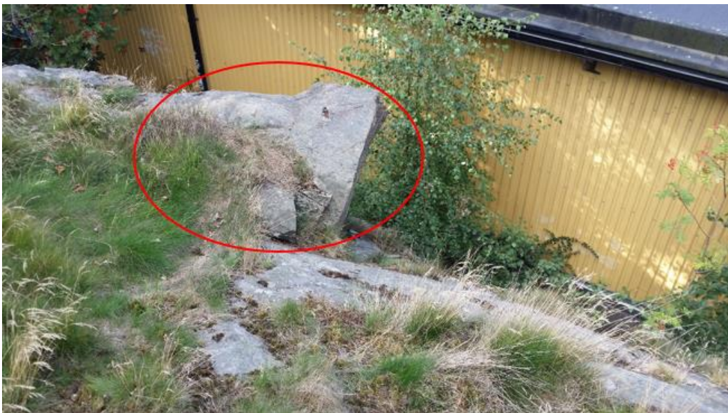
Figur 5.6. Vy från ID 5, löst block ner mot befintlig byggnad.
