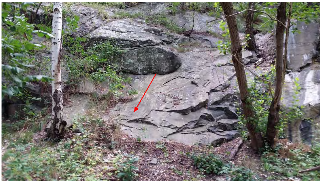
Figur 3 Vy från ID 1, där risk finns för blocknedfall på grund av strukturerna
