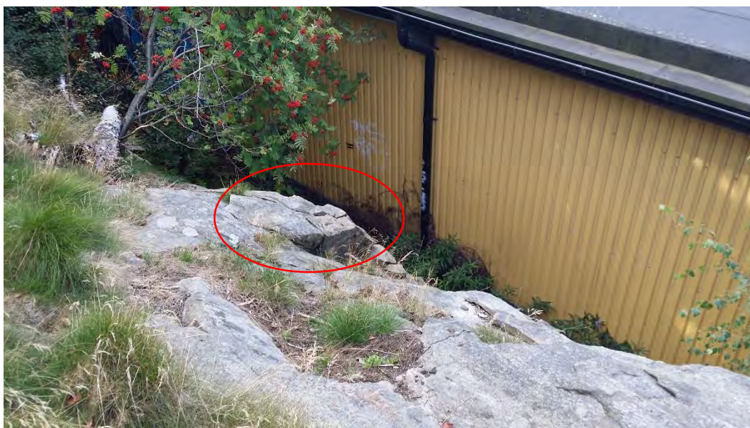
Figur 11 Vy från ID 5, löst parti med glidyta ner mot befintlig byggnad
