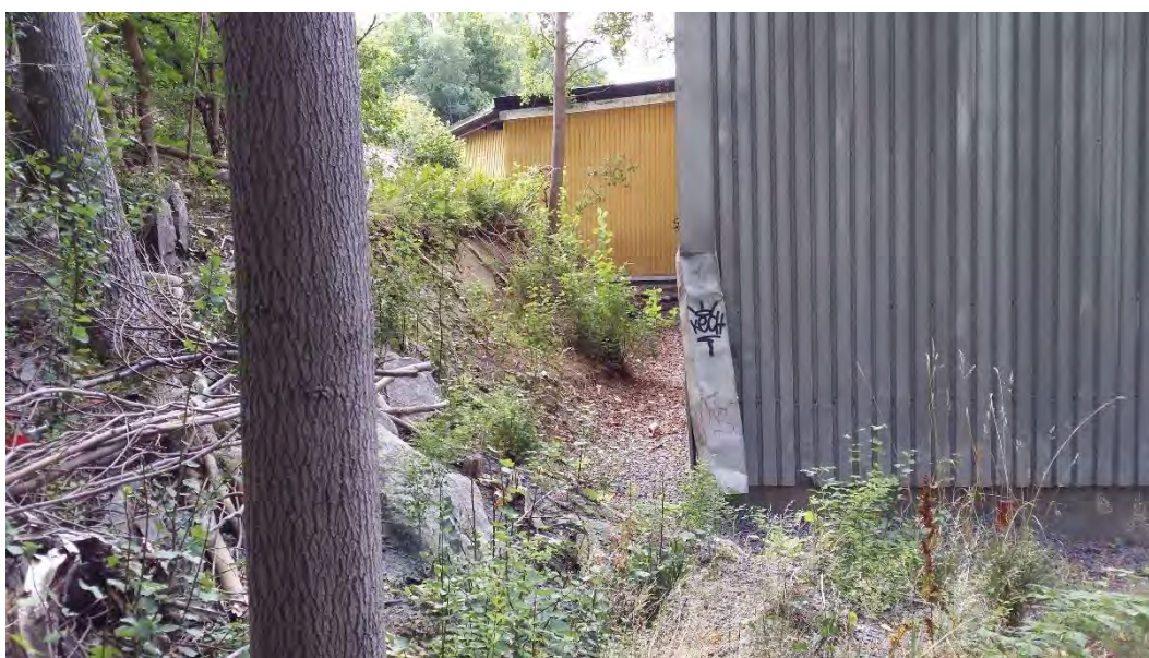
Figur 8 Vy från ID 4, där det finns lösa block invid befintlig byggnad
